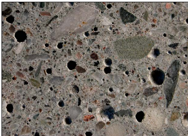
Obr. 6. Špatně zhutněný beton s velkým množstvím vzduchových pórů
