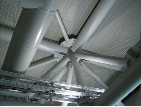
Prostorová příhradová konstrukce letištní haly v Římě, foto: prof. Ing. Alois Materna, CSc., MBA Prostorový svazek sil 16 / 56
