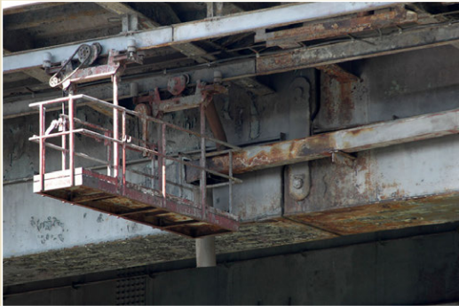
Ocelový most přes řeku Odru z roku 1980, délka 130 m, hmotnost 2.840 t, Ostrava - Svinov
