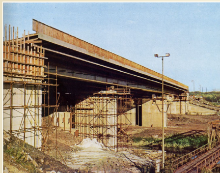
Ocelový most přes řeku Odru z roku 1980, délka 130 m, hmotnost 2.840 t, Ostrava - Svinov
