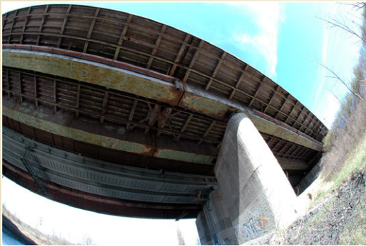
Ocelový most přes řeku Odru z roku 1980, délka 130 m, hmotnost 2.840 t, Ostrava - Svinov
