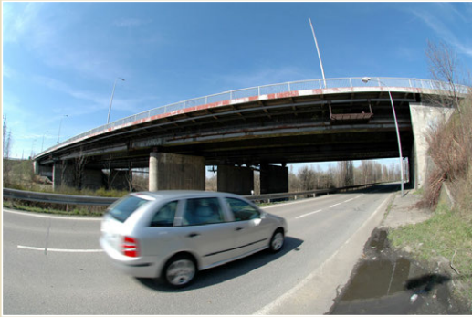
Ocelový most přes řeku Odru z roku 1980, délka 130 m, hmotnost 2.840 t, Ostrava - Svinov
