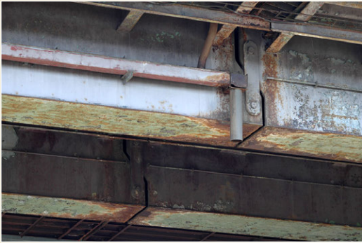
Ocelový most přes řeku Odru z roku 1980, délka 130 m, hmotnost 2.840 t, Ostrava - Svinov
