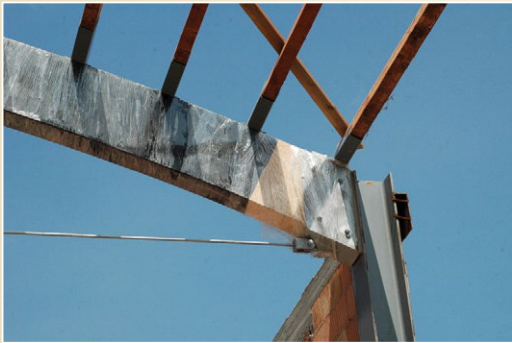
Konstrukce obloukové nosné konstrukce s táhlem, výzkumné energetické centrum VŠB-TU Ostrava Trojkloubový rám a oblouk s táhlem 115 / 129
