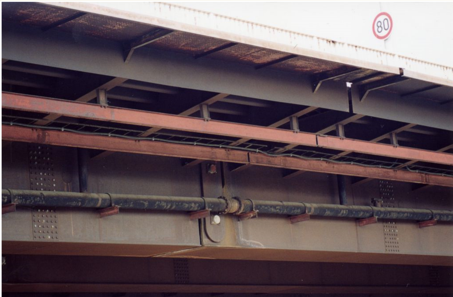
Most přes železniční trať z roku 1980, Ostrava – Svinov, délka 130 m, hmotnost 2.840 t
