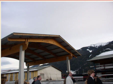
Nosná konstrukce střechy z lepeného lamelového dřeva, Stýrsko v Rakousku, foto: prof. Ing. Antonín Lokaj, Ph.D. Výpočet nosníku v příčné úloze (ve svislé hlavní rovině xz ) 75 / 110
