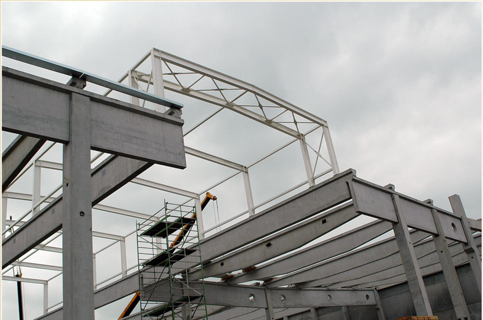
Převislé konce železobetonového skeletu, supermarket Albert, Ostrava-Poruba
