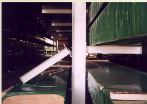
Destrukce konzolového nosníku, hala Žďárec, foto: Prof. Ing. Radim Čajka, CSc.
