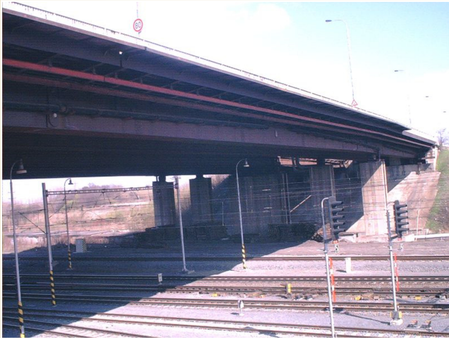
Most přes železniční trať z roku 1980, Ostrava – Svinov, délka 130 m, hmotnost 2.840 t
