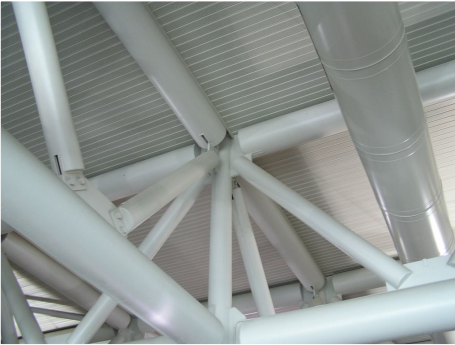
Prostorová příhradová konstrukce letištní haly v Římě, foto: prof. Ing. Alois Materna, CSc., MBA Prostorový svazek sil 15 / 56
