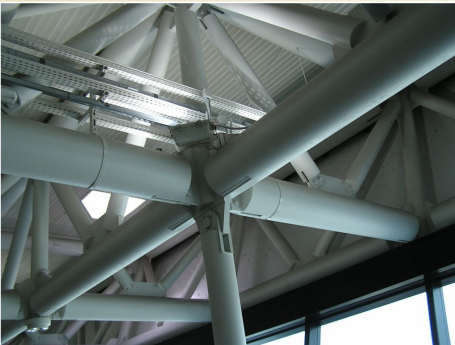
Prostorová příhradová konstrukce letištní haly v Římě, foto: prof. Ing. Alois Materna, CSc., MBA Prostorový svazek sil 17 / 56
