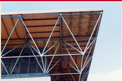
Prostorová příhradová ocelová konstrukce bývalého zimního stadiónu v Brně, autor nosné konstrukce: Ing. Dr. Ferdinand Lederer
