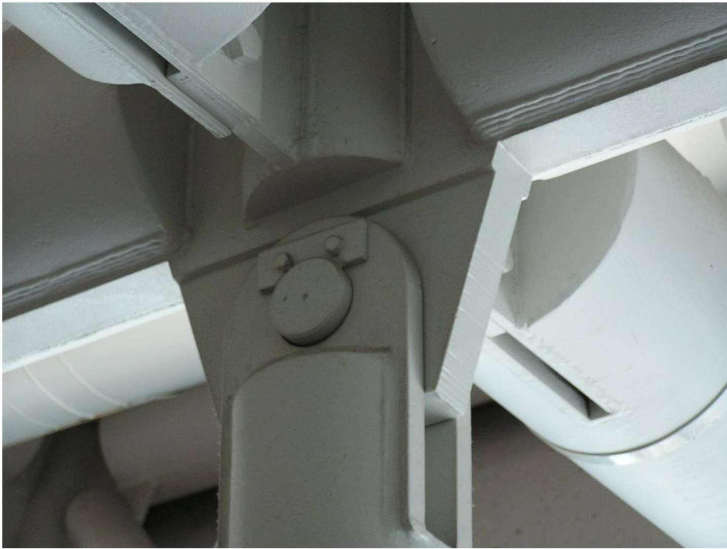
Prostorová příhradová konstrukce letištní haly v Římě, foto: prof. Ing. Alois Materna, CSc., MBA
