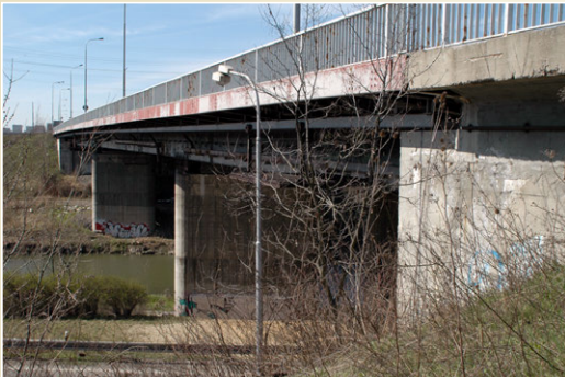
Ocelový most přes řeku Odru z roku 1980, délka 130 m, hmotnost 2.840 t, Ostrava - Svinov Spojitý nosník s vloženými klouby 45 / 129
