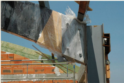
Konstrukce obloukové nosné konstrukce s táhlem, výzkumné energetické centrum VŠB-TU Ostrava Trojkloubový rám a oblouk s táhlem 116 / 129
