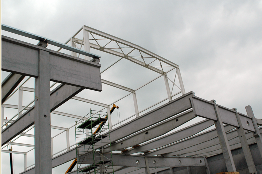
Převislé konce železobetonového skeletu, supermarket Albert, Ostrava-Poruba
