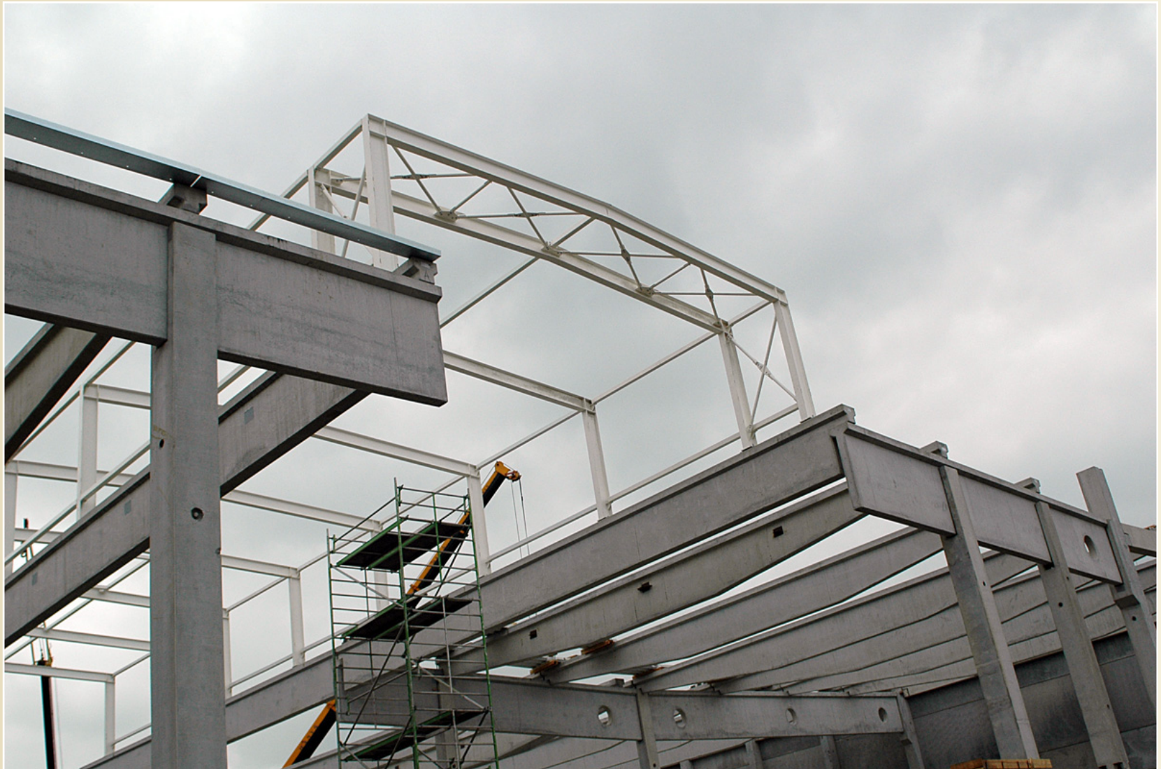
Převislé konce železobetonového skeletu, supermarket Albert, Ostrava-Poruba
