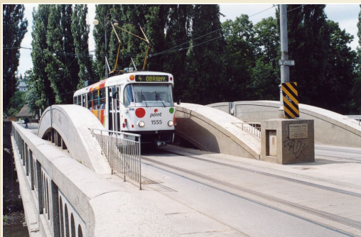
Maloměřický most z roku 1928, 3 oblouky o rozpětí 33 m s průřezem 1 m 2 , mezilehlá mostovka, Brno
