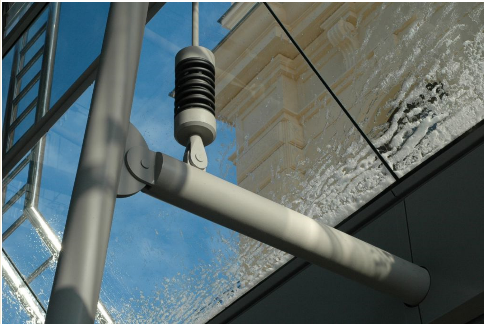
Kloubové spojení prutů konstrukce vstupní haly, nádraží Ostrava - Svinov
