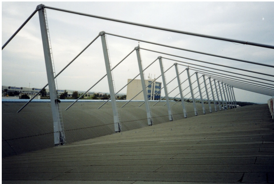
Hangár „F“ Ruzyně - první hala v ČR navržena podle metody mezních stavů (1966, M.Horák)
