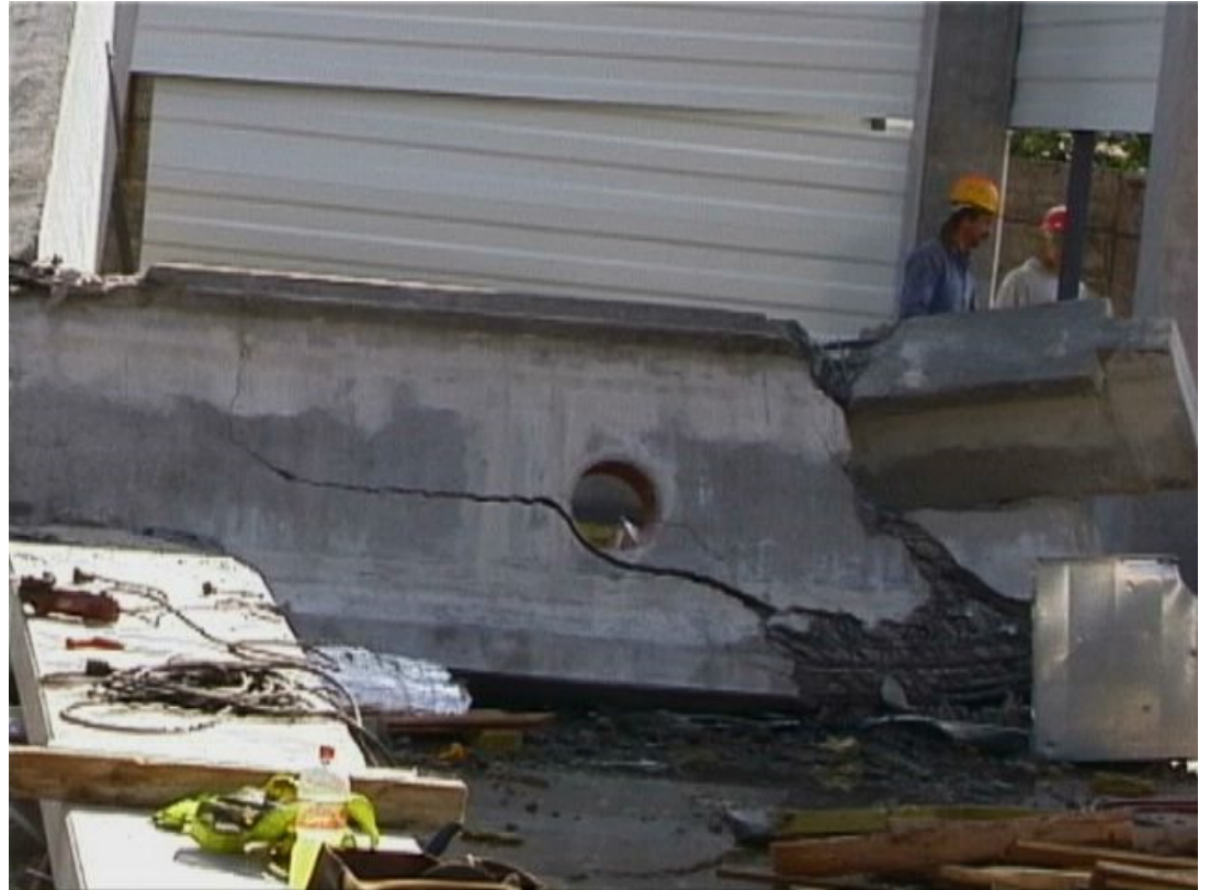
Destrukce betonového vazníku, foto: Prof. Ing. Radim Čajka, CSc.
