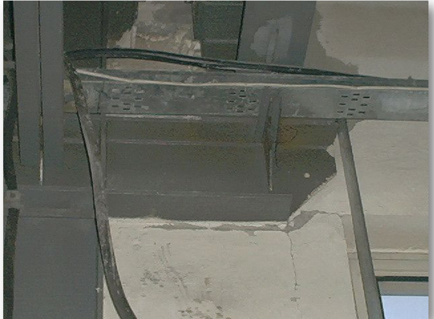
Porušení štítové stěny vlivem nerespektování přetvoření konzoly jeřábové dráhy, hala Baška
