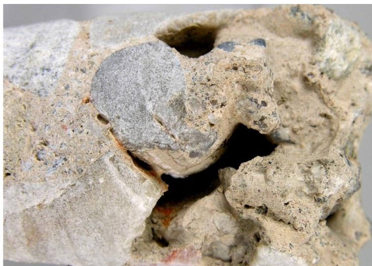
Obr. 71 Vzorek betonu postiženého korozí vyluhováním (část vrtného jádra z inspekčního vrtu provedeného do konstrukce)
