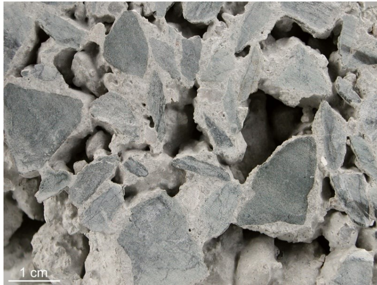
Obr. 35 Řez vzorkem mezerovitého betonu.
