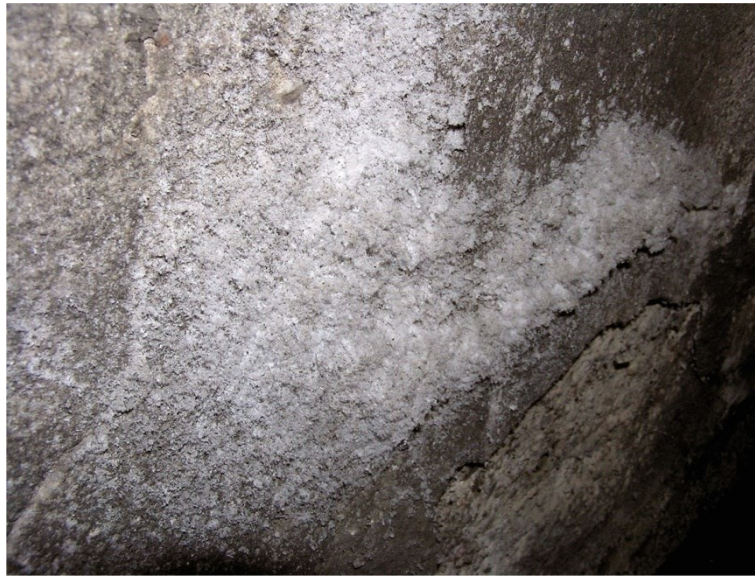
Obr. 72 Sádrovcové výkvěty na povrchu betonové konstrukce
